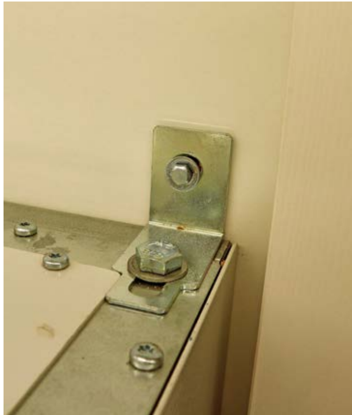
Einfache Massnahme: Die Steuerschränke in der Technikkabine der Zentralbahn in Horw sind an der Wand festgeschraubt.
